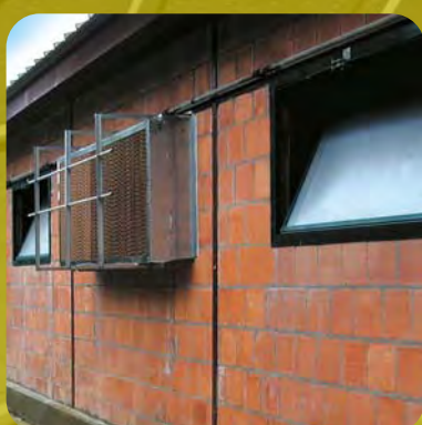
Sistema di ventilazione e raffreddamento con finestra automatica
